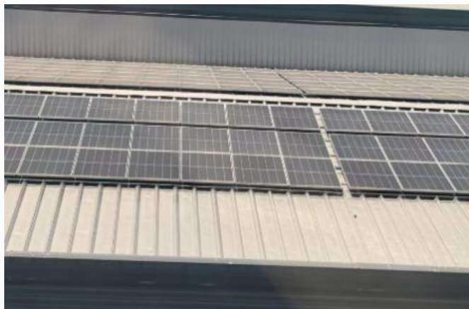
厂区屋顶光伏发电
